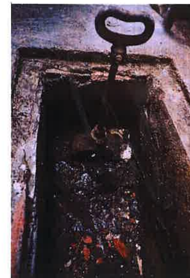
II. 72 Uszkodzony zawór odpływowy w posadzce w piwnicy
