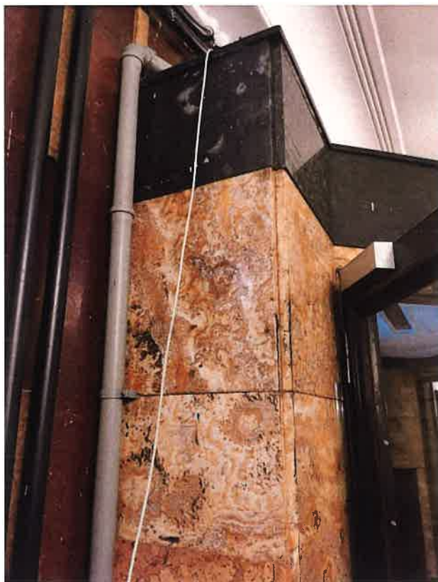
Il. 85 Uszkodzenie okładziny przez instalację techniczną
