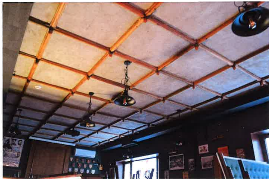
II. 102 Strop kasetonowy na piętrze
