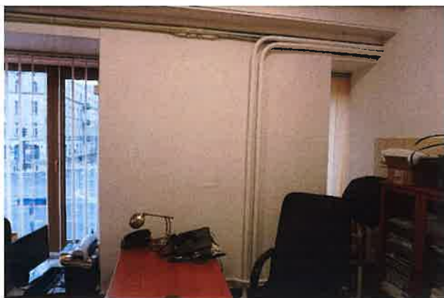
Il. 88 Przesłonięcie marmurowej okładziny tynkiem i farbą (pomieszczenia administracyjne)
